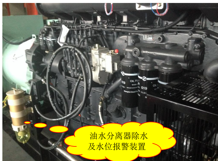
图 3-27 油水分离器除水及水位报警装置
